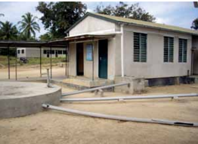
Defekt vannrør ved en helseklinikk i Tanzania. Foto: Riksrevisjonen
